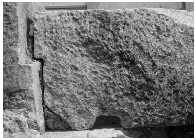
図147 天井石合欠きの組み合わせ（漆喰除去後の天井石3・4東側面）
