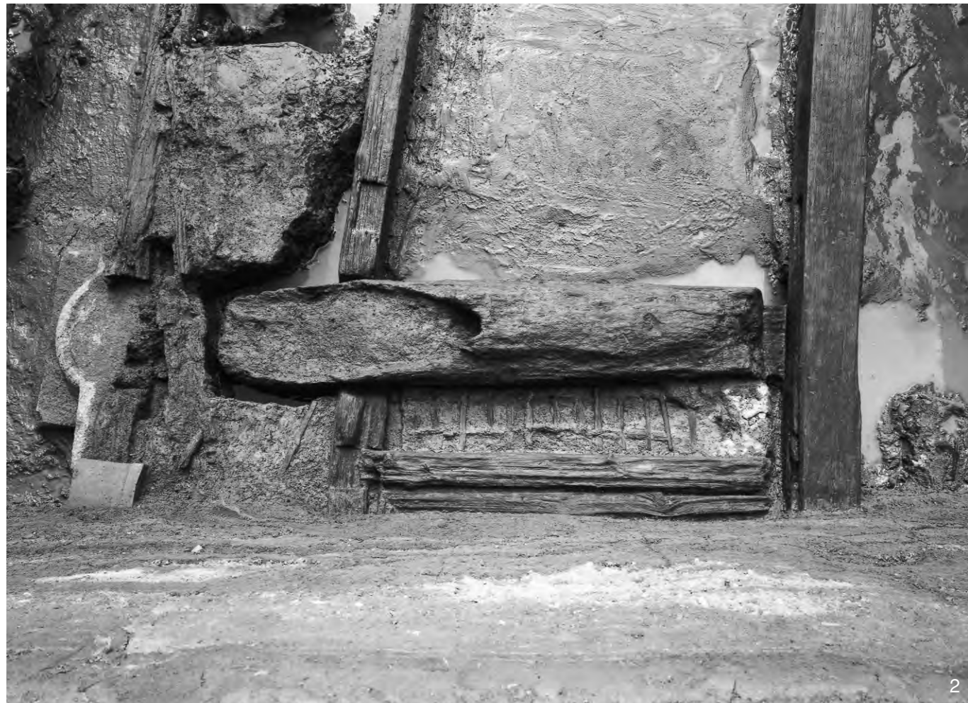
1 建築部材・瓦倒壊状況(南から8・9間目) 東から 2 柱(東柱筋南から10本目)と壁 北から
