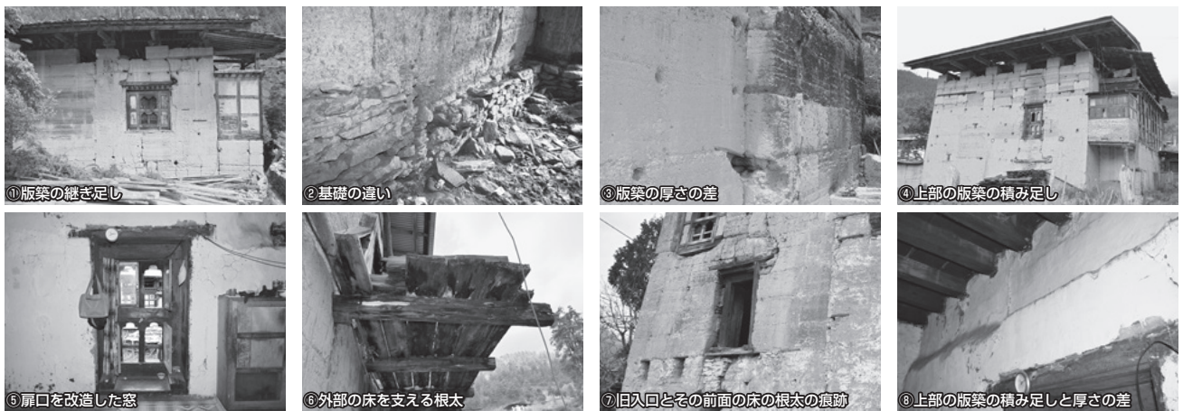
図12 改造変遷の様々な痕跡
